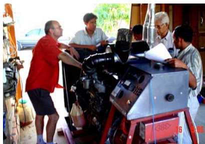
Groupe électrogène monté par nos formateurs
